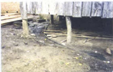
Tratamento inadequado das águas servidas
